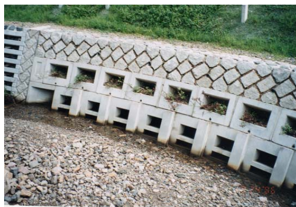
写真2 護岸の下に濡すじがある
