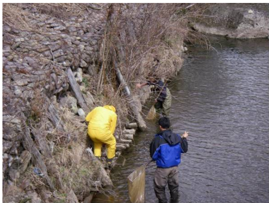
写真 4 河岸には木工沈床の隙間がたくさんある
