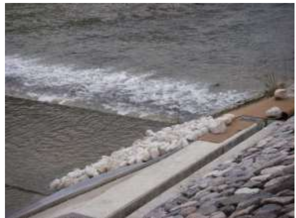
写真 20. すずかけ（バイパスと設置状況）
