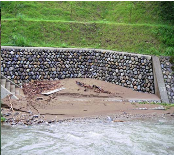
写真6 大量の土砂が堆積
