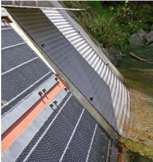
写真7 保護センターのポンプ・ピットのカバーも曲がる
