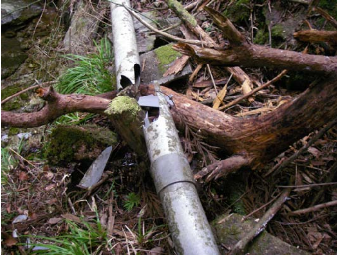
写真1 破損した水源のパイプ
