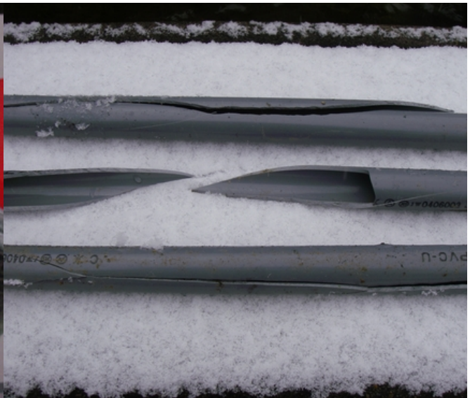
写真4 バリバリに割れたエンビパイプ
